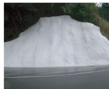
吹付法面の老朽化対策
